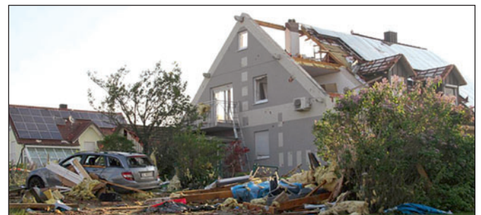
Abb. 4: Abgedecktes Dach durch den Tornado im Raum Aichach-Friedberg im Jahr 2015
